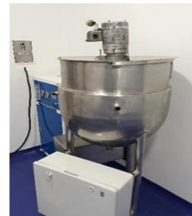
КОТЕЛ ВНЕ ЭКСПЛУАТАЦИИ
